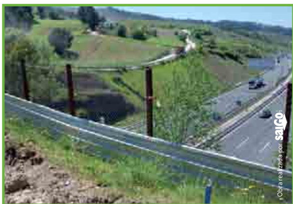
Cierre de contención
